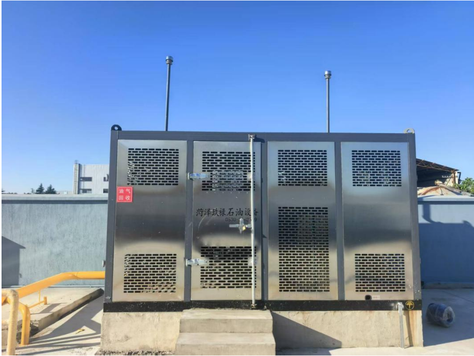
油气回收处理装置
