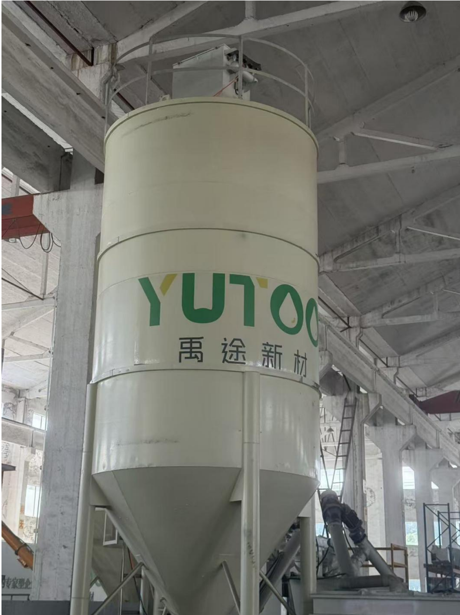
仓顶无动力式布袋 除尘器
